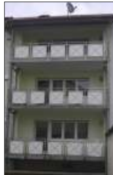
„Neues Outfit“: Die alten Balkone wurden abgesägt und thermisch vom Gebäude getrennt.
